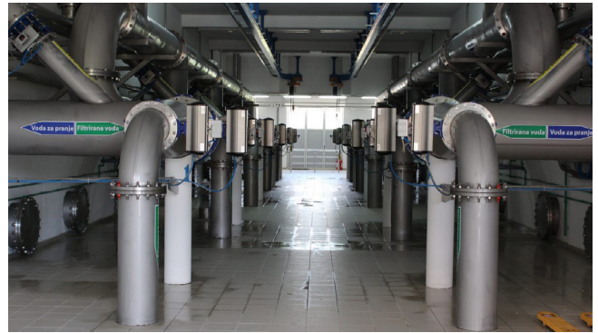
Wasserwerk: Filtersystem mit Sensoren
