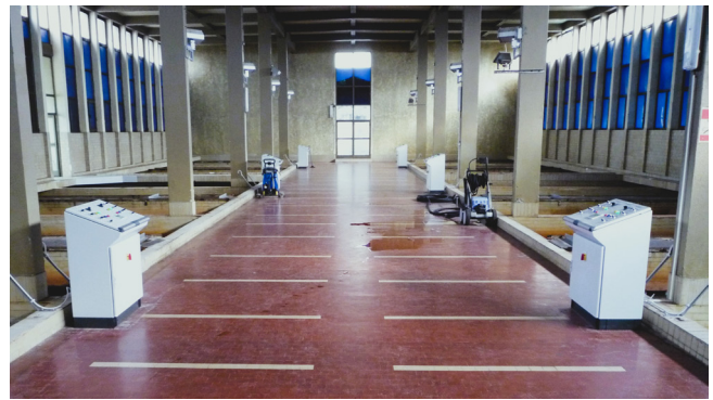
Wasseraufbereitungsanlage für Trinkwasser
