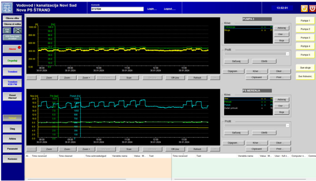
Pumpstation Štrand: Systemparameter und Messung von Strom, Druck und Durchfluss
