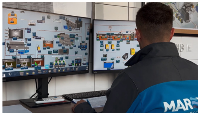
Sterownia – pełen podgląd procesu oczyszczania ścieków.
