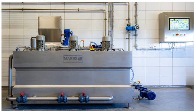
Stacja polielektrolitu z panelem operatorskim.
