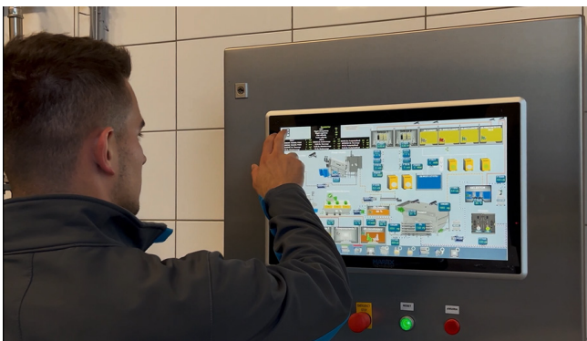
Panel HMI w oczyszczalni ścieków.
