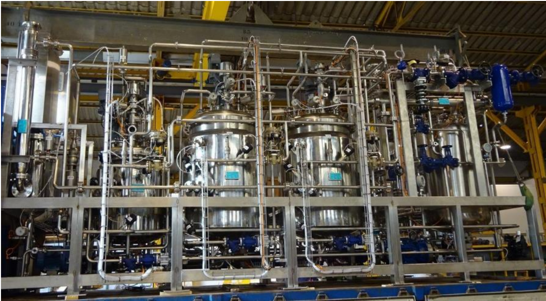
Classico impianto in acciaio inox
